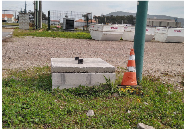
Figura 1 - Exemplo de caixa elevada (desconsiderar tampa).
